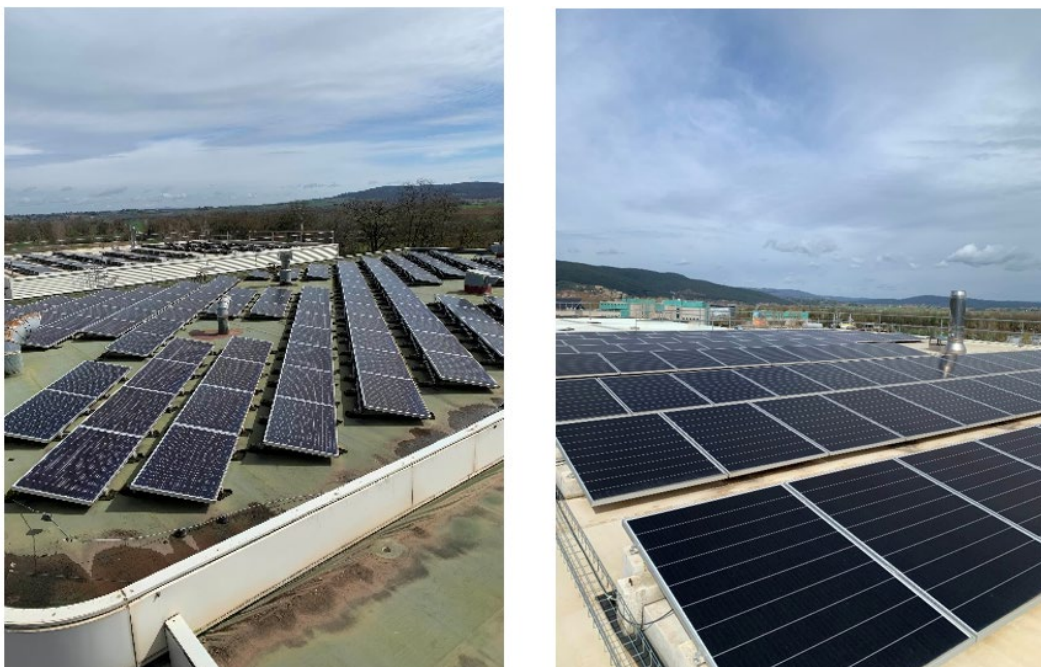
Figura 15 - Sulla sinistra impianto fotovoltaico 40 KW; sulla destra impianto fotovoltaico 70 KW
