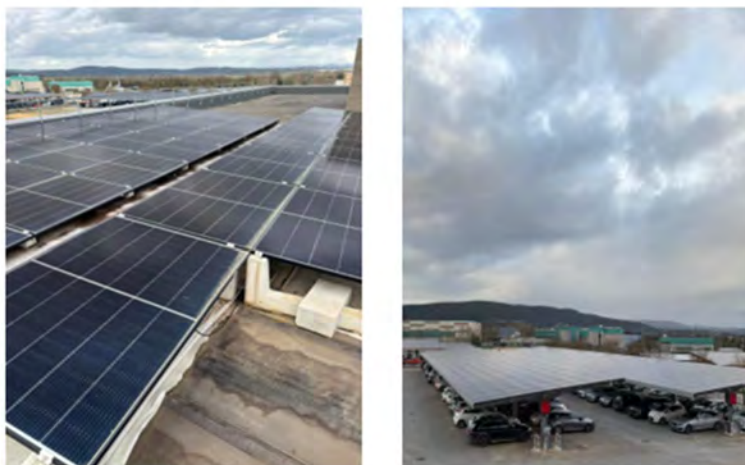
Figura 17 – Sulla sinistra impianto fotovoltaico 30 KW; sulla destra impianto fotovoltaico 380 KW
